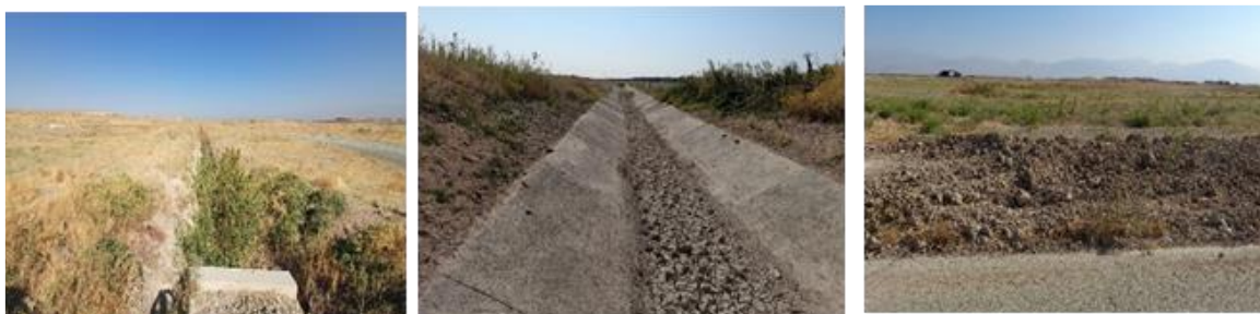
شکل ۵ - دشت‌های ماندابی و آبیگرهای فصلی در مجاورت باند پرواز که سبب جلب پرندگان آبی و کنسار آبی می‌شود. - عدم لایروبی کانال زهکشی و هدایت آب از اطراف باند پرواز سبب تجمع آب در فصول پاییز و زمستان در اطراف باند می‌شود.
